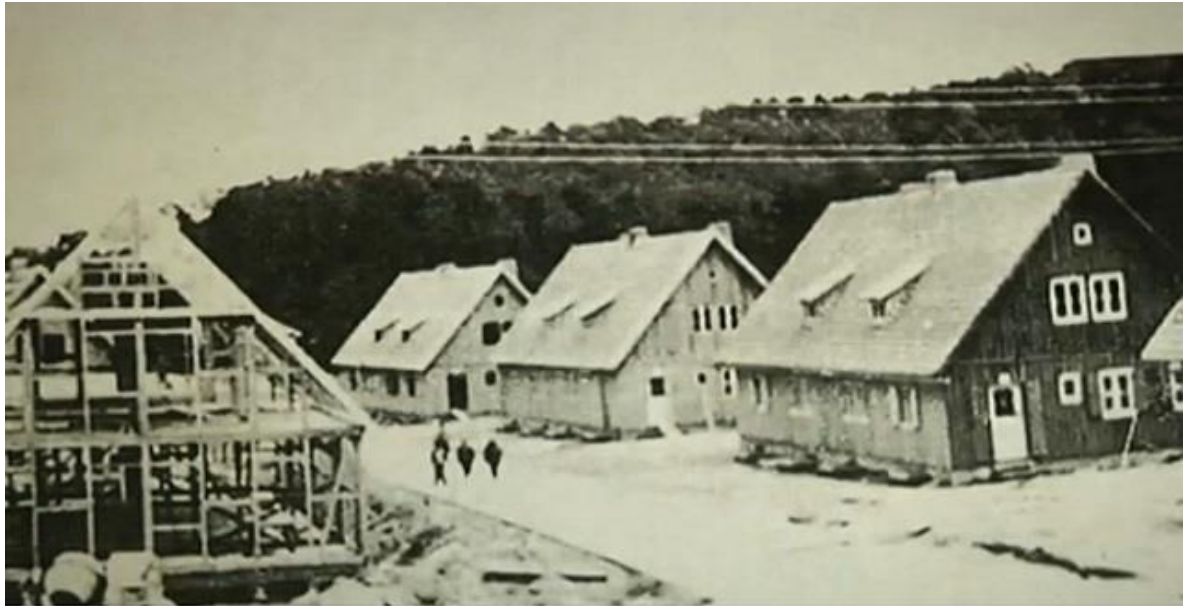
Fot. Pustki Cisowskie, budowa domów dla niemieckiego lotnictwa, 1940 rok. Obecnie ul. Pawia.
