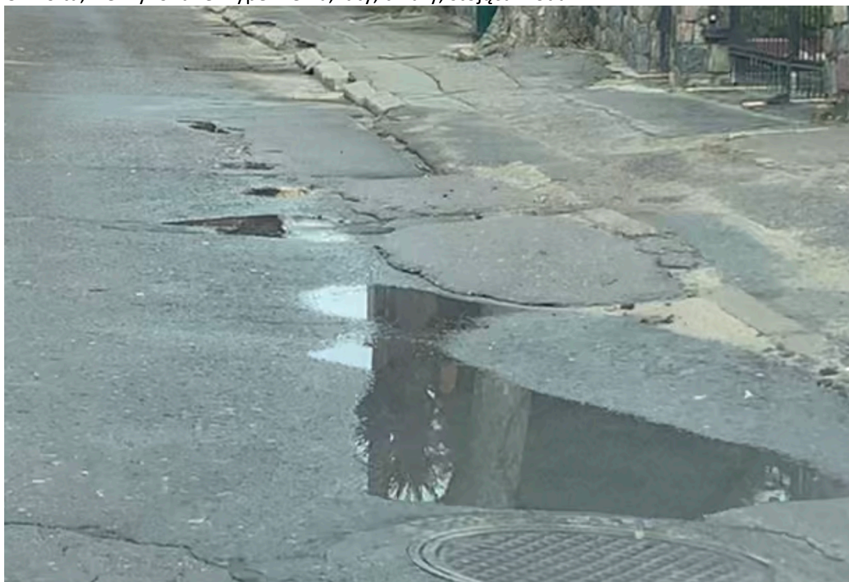
Ul. Żółta, źle wykonane wypełnienia, łaty, dziury, stojąca woda
