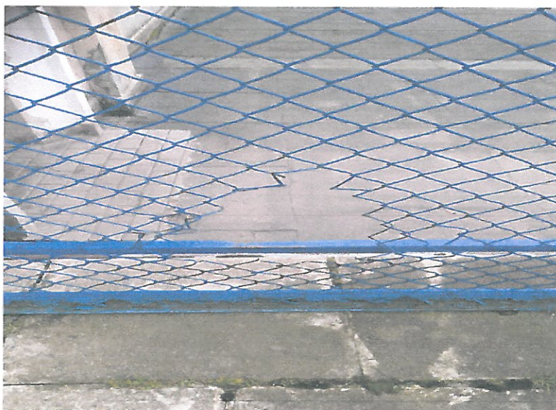
ZDJĘCIE 5: STAN SIATKI OGRODZENIOWEJ
